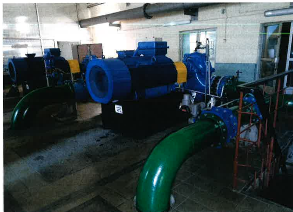
Istniejąca Pompa nr 2 - 30B50.
